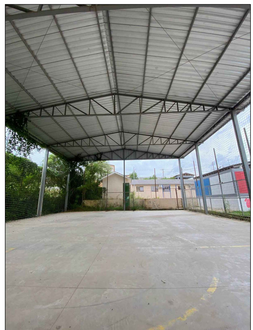
IMAGEM 02: FECHAMENTO LATERAL DA QUADRA COBERTA.
